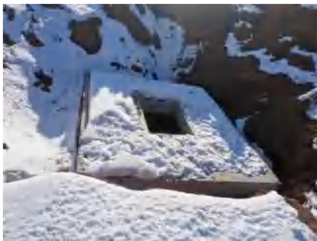
厂区现状排水井
